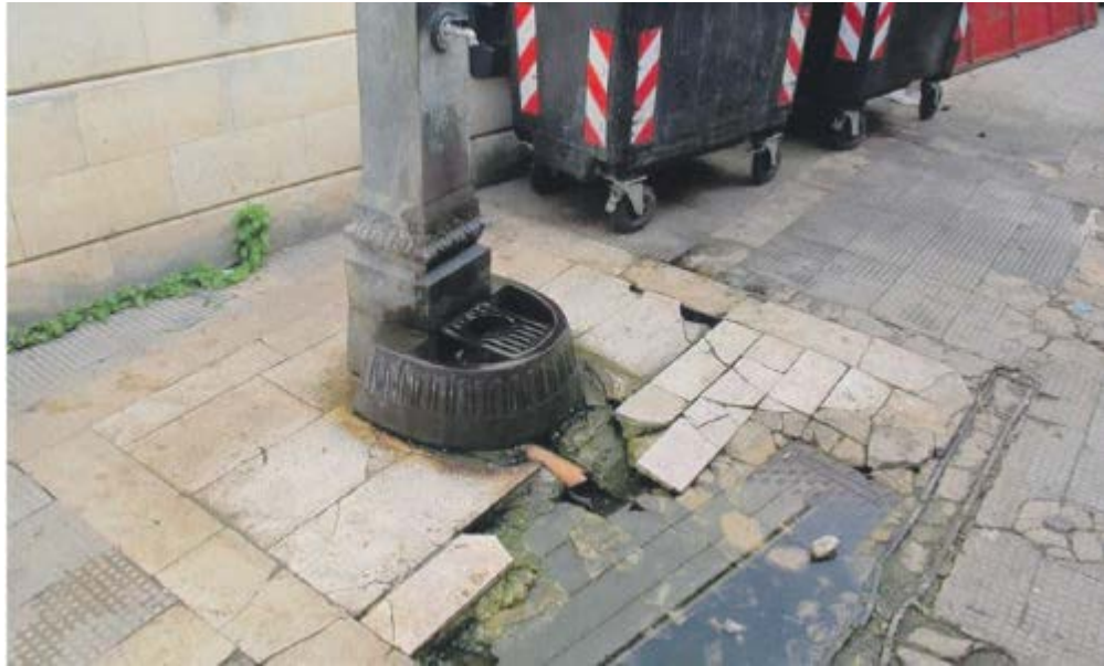
Fontana in evidente stato di degrado nel mercato coperto di via Padre Annibale di Francia
